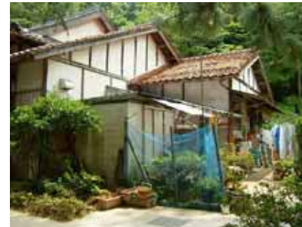
管理人室が設置されたこともあり、歴史的建物の外観を阻害している部分がある。歴史ある打吹公園の景観に配慮した補修が必要である。
