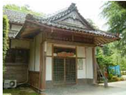
床は地面から2尺5寸上がりである。スロープなどの身障者に配慮した施設の充実が必要である。
