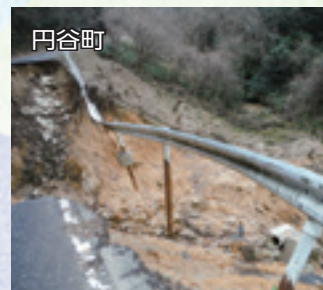
▲令和5年8月15日台風7号による林道災害
