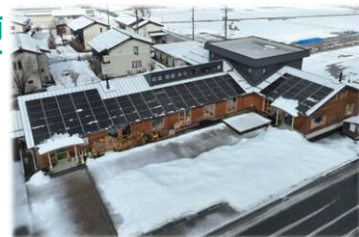
融雪機能付き太陽光パネル
