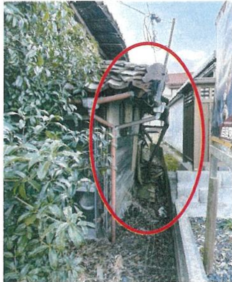
1-1④ ※隣家の車庫側に傾いている
