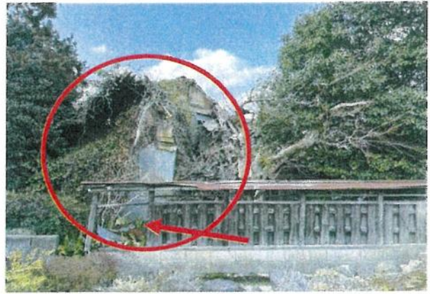
※今年、○部分が崩れ落ち、←の 1-1② 箇所から隣家の庭に破片が落ちている
