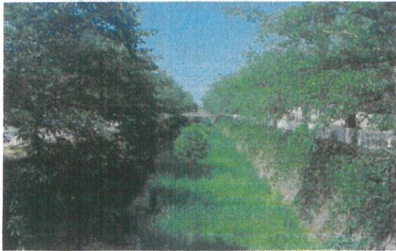
○ No.1 会下谷川の河床・法面の樹木
