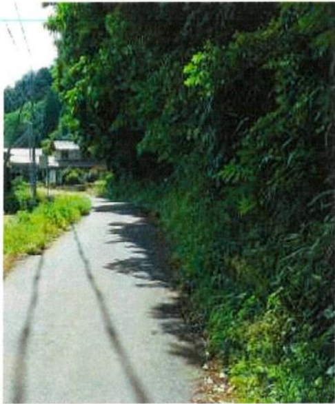
側溝が埋まってしまった市道陽線④・1 道路に湧水が常に横断している〔崩地内〕
