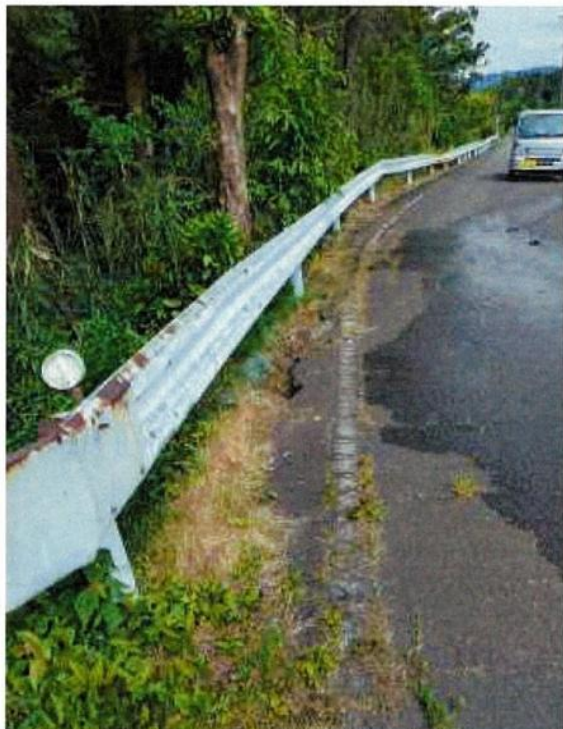
写真①倒れかかったガードレール
