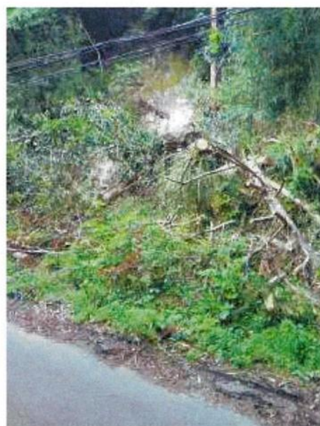
崩れた法面と倒木②
