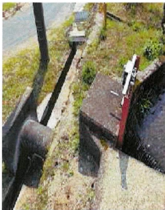
②余水吐ゲート（吐水と田中地区への分離）
