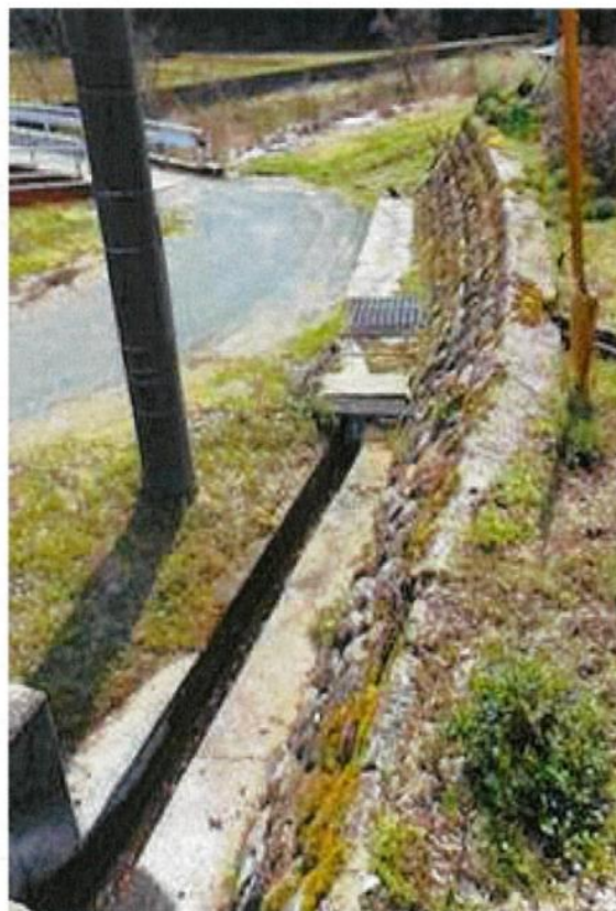
④拡張を要望する側溝
