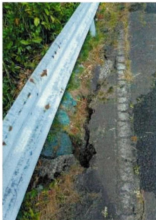
写真②舗装部分に亀裂が入り崩れている
