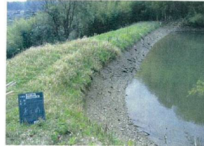
漏水が生じているため池
