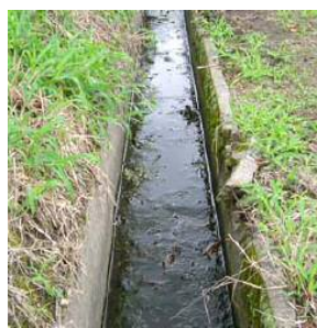
部分的な欠損
