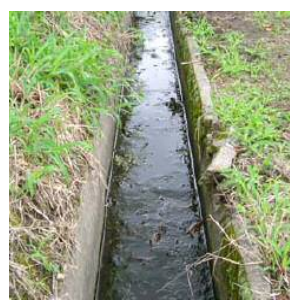
部分的な欠損
