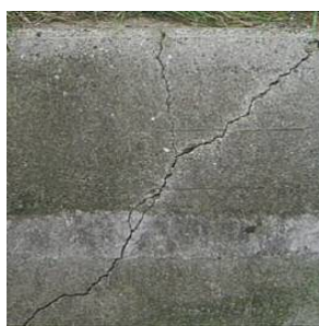
斜め方向のひび割れ
