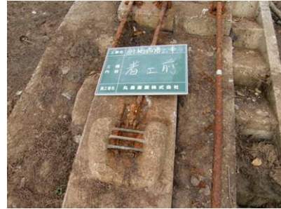
ため池における 老朽化したゲート
