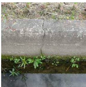
縦方向のひび割れ
