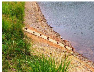
老朽化した取水施設
