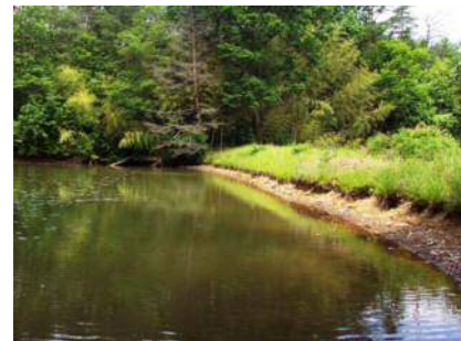
堤体が洗掘されているため池
