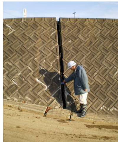
ブロック積みの隙間
