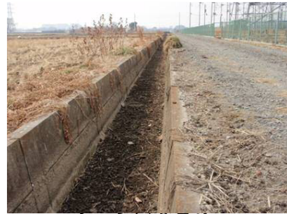
安全施設がない水路
