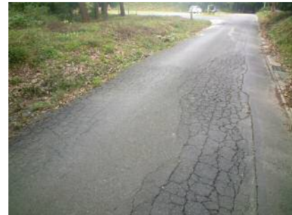
アスファルト舗装の老朽化
