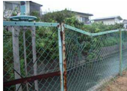
破損した金網フェンス
