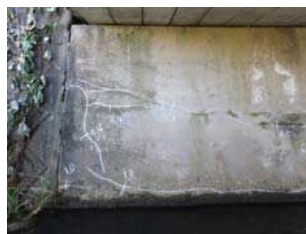
コンクリートのひび割れ
