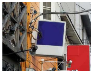
上部構造全体が傾斜した状態
