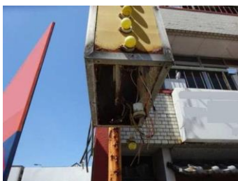
側板底面が欠損した状態
