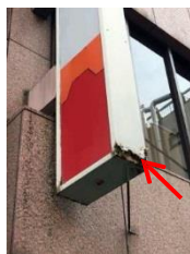
広告板底部の腐食が進行した状態
