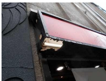
側板底面の腐食が進行した状態
