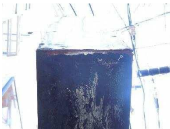
側板底面にさびが発生した状態
