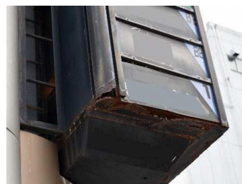
側板底面が腐食、破損した状態
