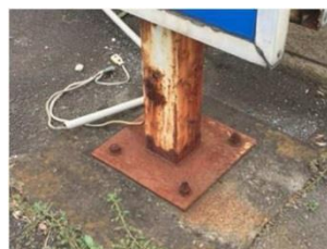
支柱、ベースプレート、アンカー共にさびが顕著な状態
