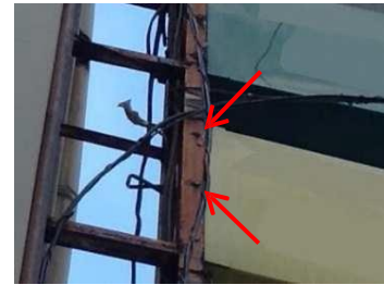
ボルトのゆるみや欠落した状態
