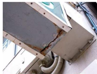
側板底面が破損した状態
