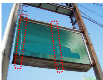
外れかかった表示面板を針金で固定した状態
