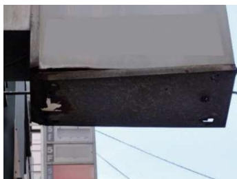
側板底面が腐食、破損、変形した状態
