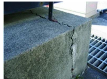
基礎にクラックが入った状態
