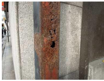
支柱の腐食が進行した状態
