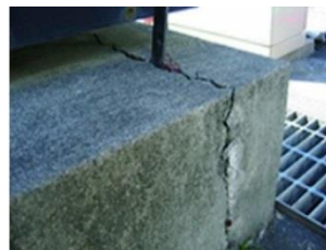
基礎にクラックが入った状態
