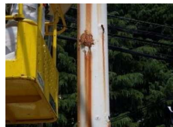
支柱の腐食が進行した状態
