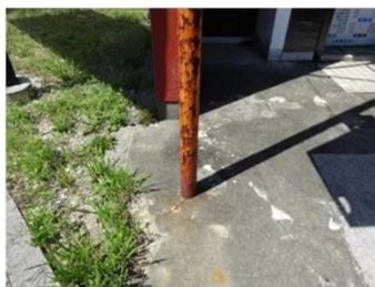
支柱の腐食が進行した状態
