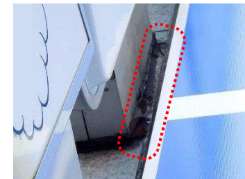
コーキングが劣化した状態
