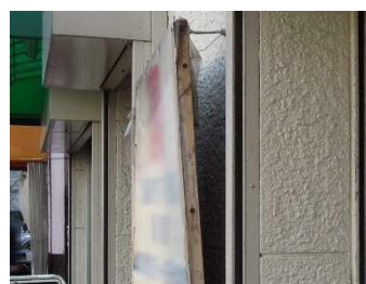
壁面との間に隙間が生じた状態
