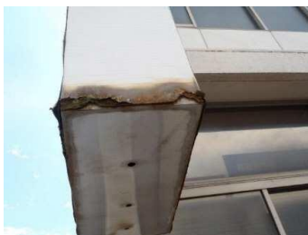
側板の腐食が進行した状態
