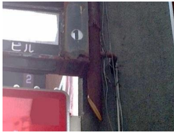
支持部が腐食した状態
