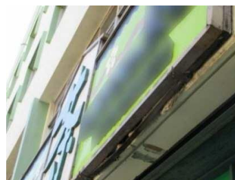
側板底面が破損した状態
