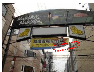
幕材を張る部材が破損した 状態
