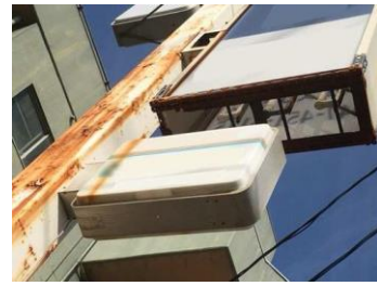
支柱にさびが発生した状態
