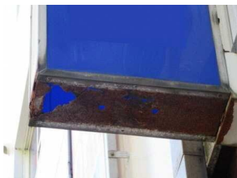
側板底面が腐食、破損した状態
