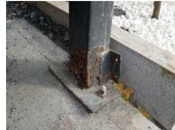
支柱根元の腐食が進行した状態
