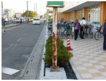
支柱の腐食が進行した状態
