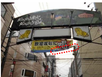
幕材を張る部材が破損した状態
