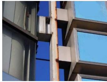
支持部が腐食した状態
