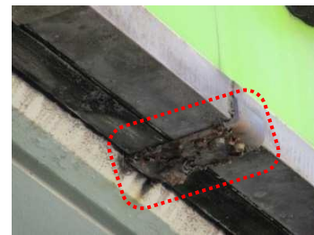
金具が劣化した状態
