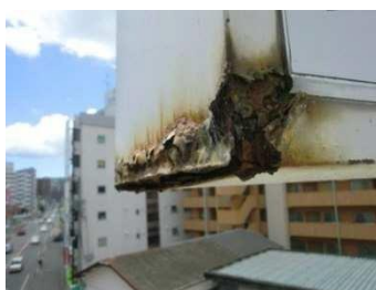
側板の腐食が進行した状態
