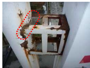
取付部の溶接部が劣化している状態
