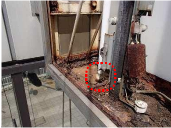
蛍光灯のホルダーが破損した状態
