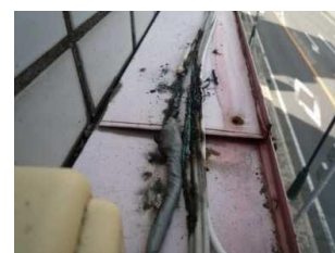
配線が劣化し、ショートした状態
