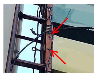
ボルトのゆるみや欠落した状態
