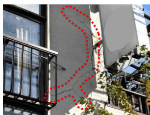
壁面にひびが生じた状態
