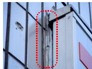
コーキングが劣化した状態
