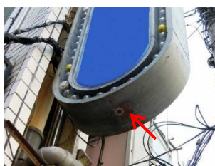
水抜き孔が詰まった状態
