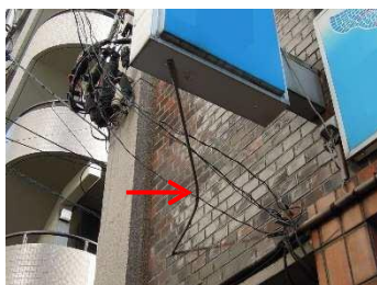
振れ止め棒が変形した状態
