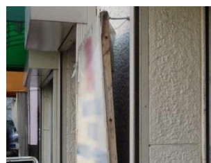
壁面との間に隙間が生じた状態
