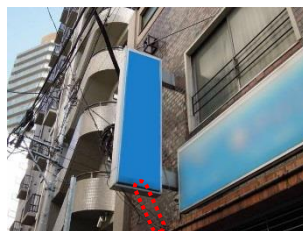
振れ止め棒が変形した状態
