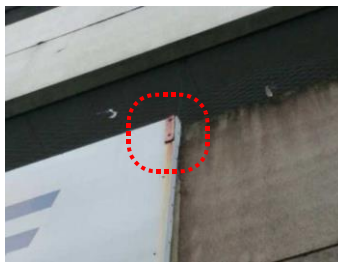
金具が劣化した状態
