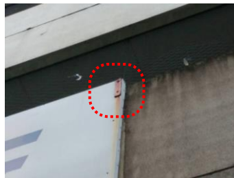
金具が劣化した状態
