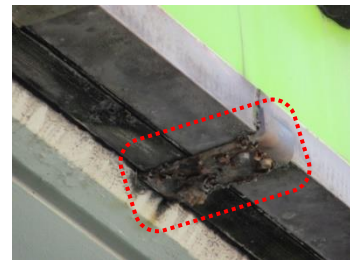
金具が劣化した状態
