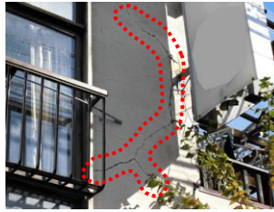
壁面にひびが生じた状態
