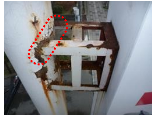
取付部の溶接部が劣化している状態
