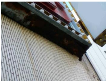
取付部の腐食が進行、汚ダレが見られる状態
