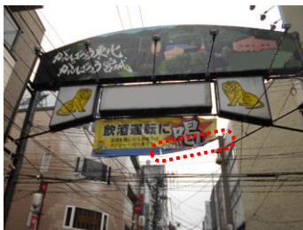
幕材を張る部材が破損した状態
