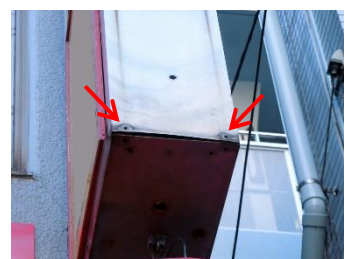
ビスが欠落し、側板が外れかかった状態
