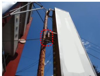
支柱・広告板接合部の腐食・隙間
