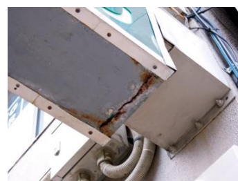
側板底面が破損した状態
