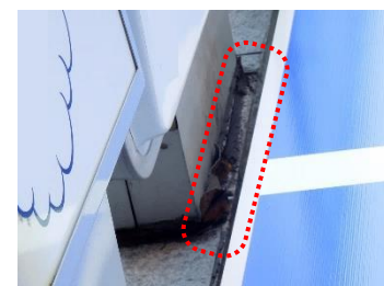
コーキングが劣化した状態
