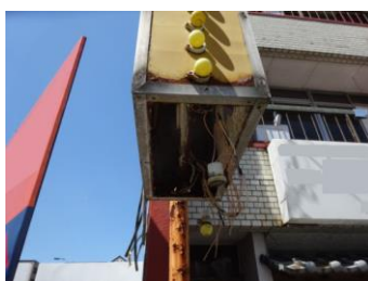
側板底面が欠損した状態
