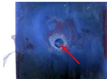
水抜き孔の詰まり
