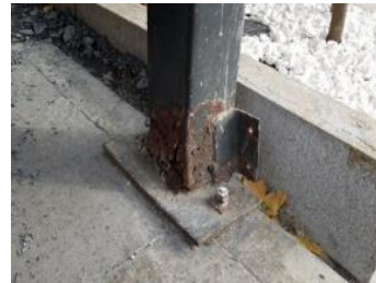
支柱根元の腐食が進行した状態
