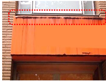
その他（塗装剥離、腐食など）
