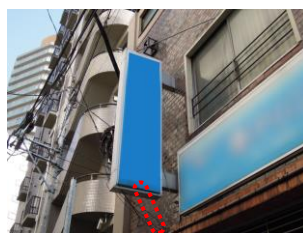
振れ止め棒が変形した状態
