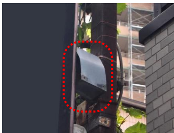
ブラケット・取付部の腐食（ブラケットカバー外れ）
