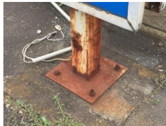
支柱、ベースプレート、アンカー共にさびが顕著な状態
