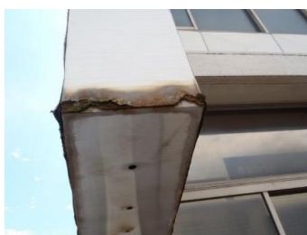
側板の腐食が進行した状態
