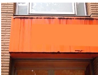
側板の腐食が進行した状態
