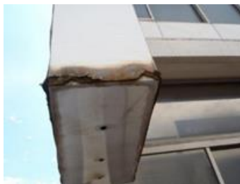
広告板底部の腐食
