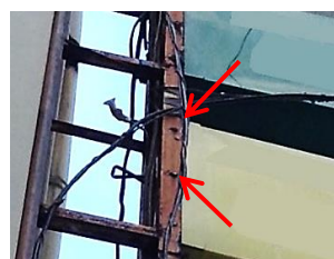
ボルトのゆるみや欠落した状態
