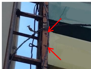
ボルトのゆるみや欠落した状態
