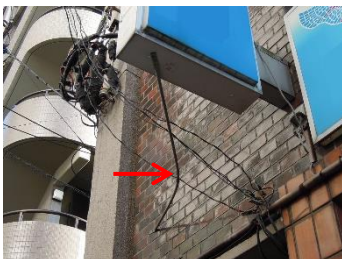
振れ止め棒が変形した状態
