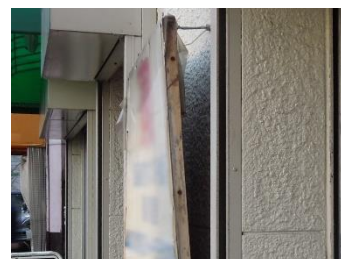
壁面との間に隙間が生じた状態
