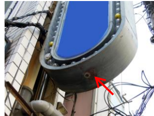
水抜き孔が詰まった状態
