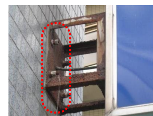
取付部プレートが腐食している状態
