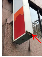
広告板底部の腐食が進行した状態
