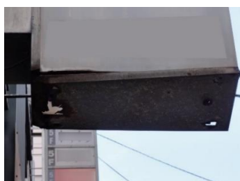
側板底面が腐食、破損、変形した状態
