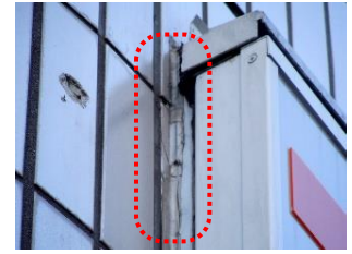
コーキングが劣化した状態
