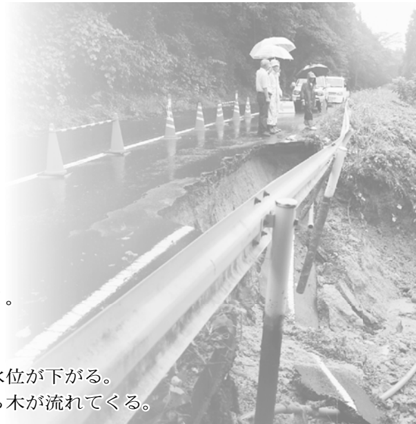
▲平成23年9月台風12号による被害(関金町堀)
