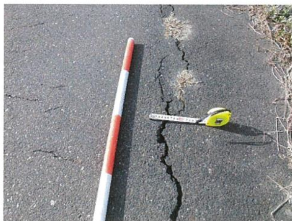
①古川沢 1 号線舗装線状クラック近景
