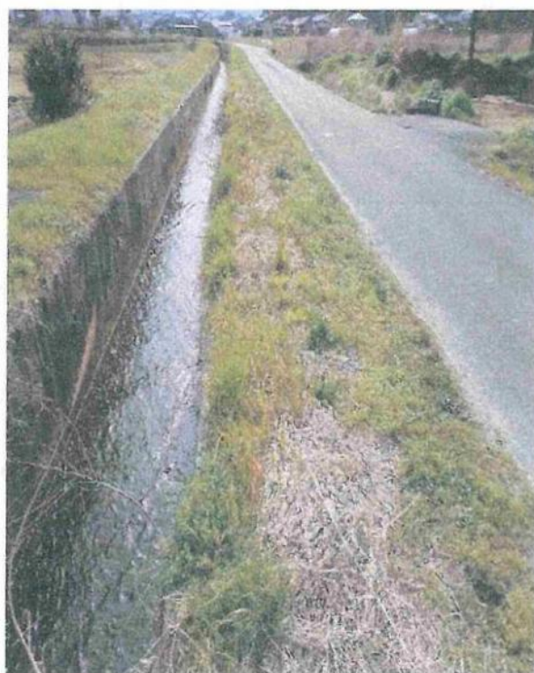
未整備道路 河川深く危険 （北側からの写真）
