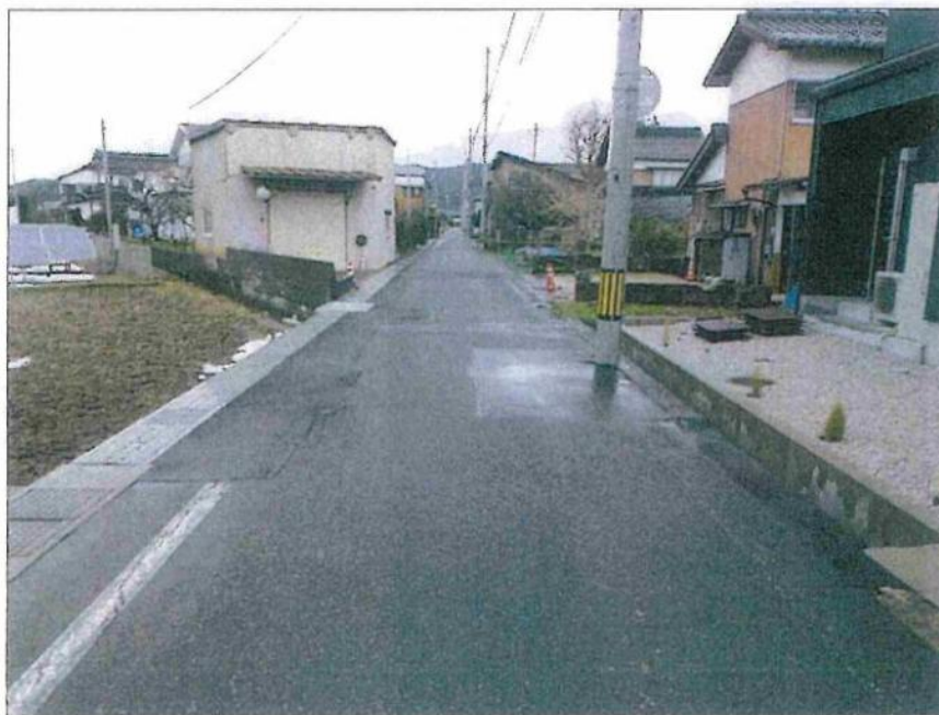
福守町自治公民館 令和6年度陳情要望 要望書④ 市道西倉吉町鴨川町2号線の外側線について 福守町273附近より上方向 外側線
