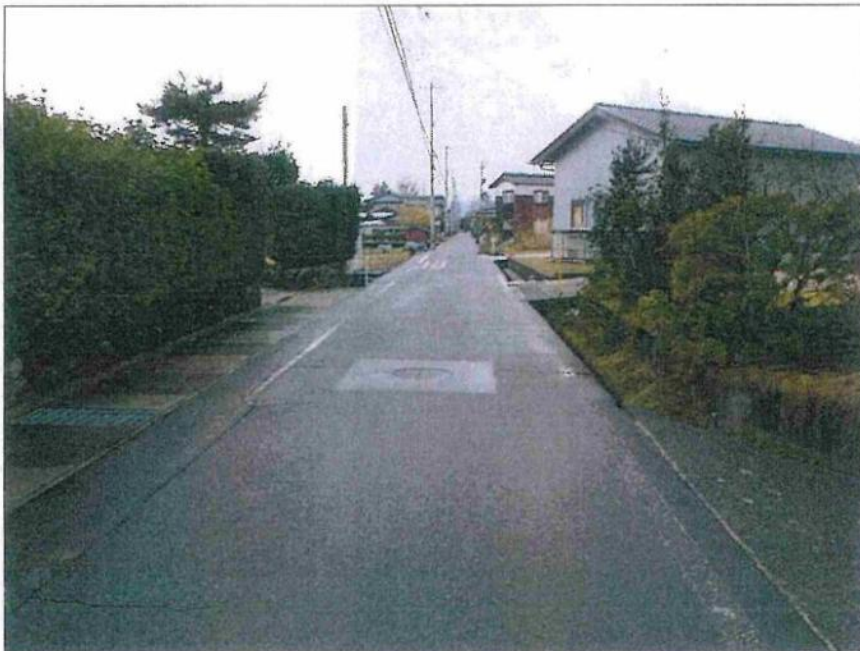
福守町自治公民館 令和6年度陳情要望 要望書④ 市道西倉吉町鴨川町2号線の外側線について 福守町93-20附近より上方向 外側線
