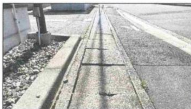
右側歩道側溝蓋段差
