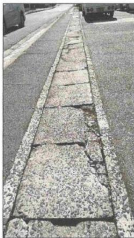
左側歩道側溝蓋破損
