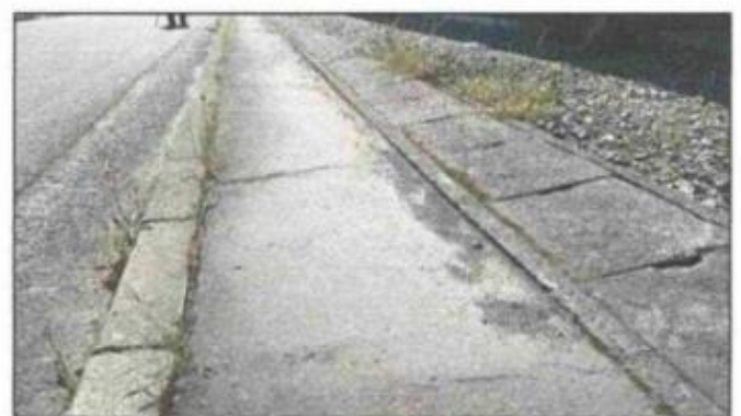
左側歩道側溝傾斜
