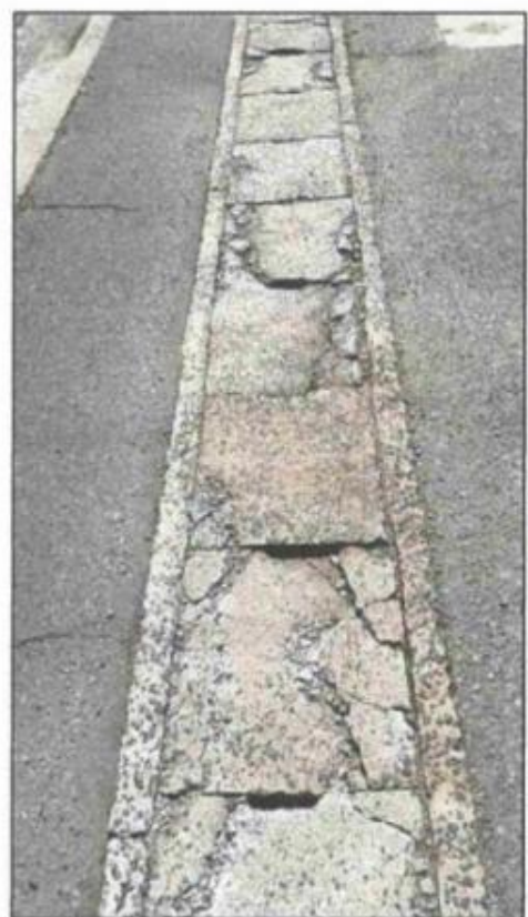
左側歩道側溝蓋破損
