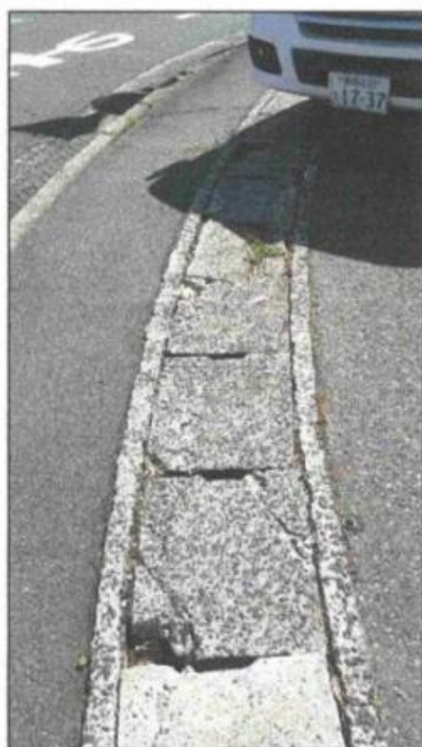
左側歩道側溝蓋破損
