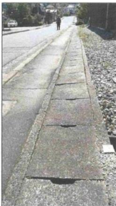
左側歩道側溝傾斜
