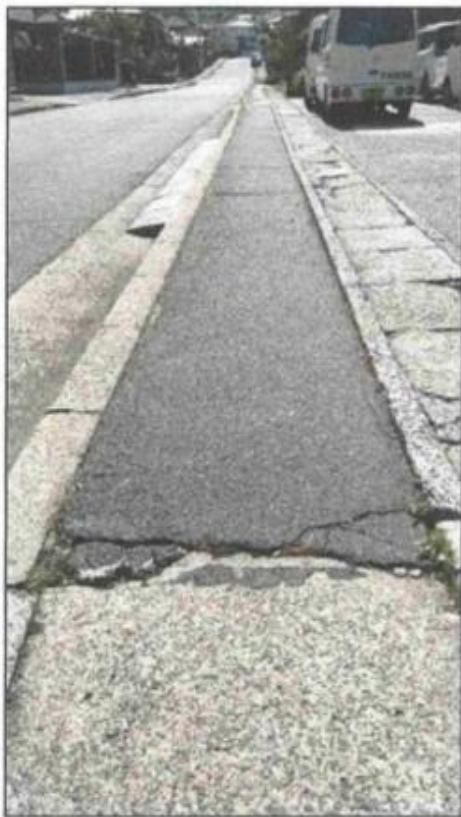
左側歩道側溝蓋破損
