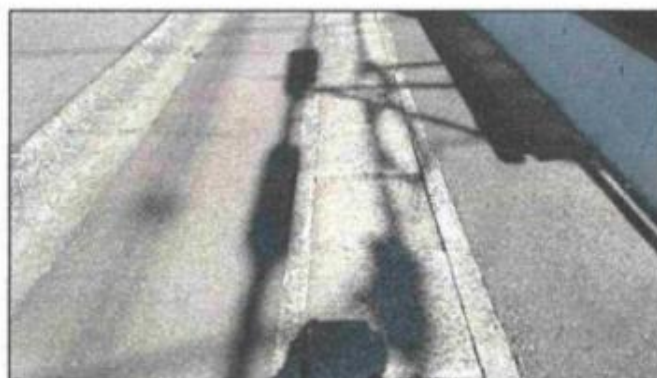
右側歩道側溝蓋段差
