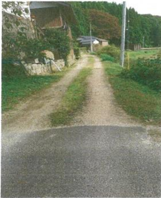
河川管理道までの間が未舗装
