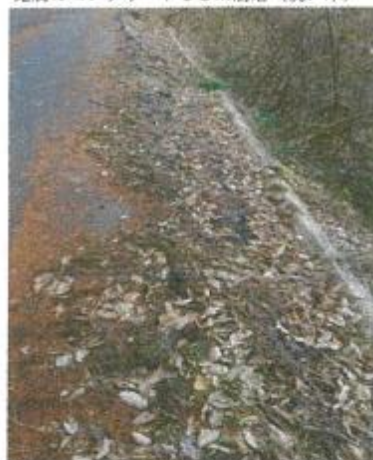
路肩のコンクリート1.2m崩落（桃ノ木）
