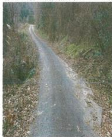
谷からの流水で路肩が陥没（ジンジャバタ）
