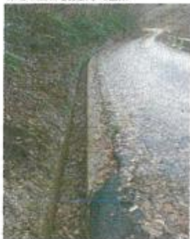
業者が土石を除去した箇所
