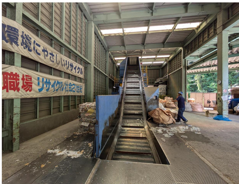
C棟・南工場内 圧縮梱包装置の状況
