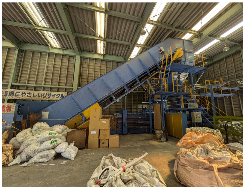
C棟・南工場内 圧縮梱包装置の状況 （高さ 5.8m）
