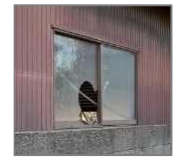
窓が割れた管理不全空家
