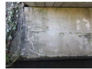
コンクリートのひび割れ
