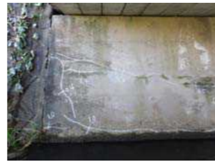
コンクリートのひび割れ
